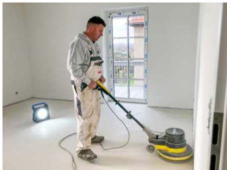
David Engelmann von der Firma Hoffmann aus Timmenrode bereitet in einer Wohnung im Obergeschoss den Fußboden im Wohnzimmer für das Aufbringen des Belages vor. FOTOS: KORN
